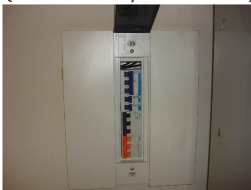
Quadro de Iluminação
